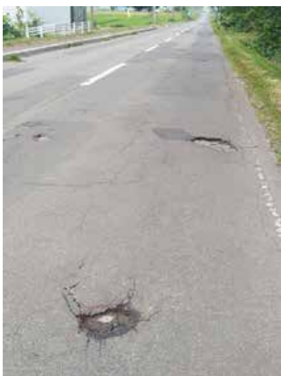
→雪解け後の損傷が激しい道路
