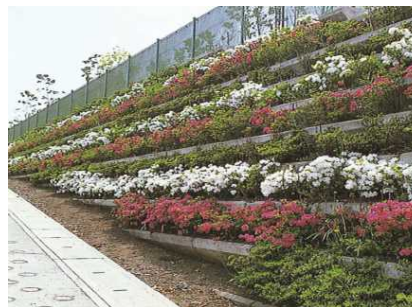
緑生擁壁の事例
