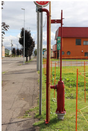
背伸び消火栓
