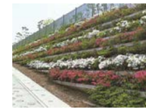
緑生擁壁の事例
