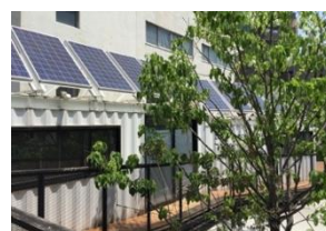
低層部分に設置された太陽光パネル
