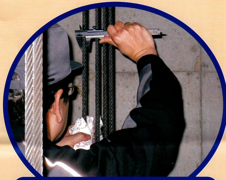
エレベーターの主索検査
