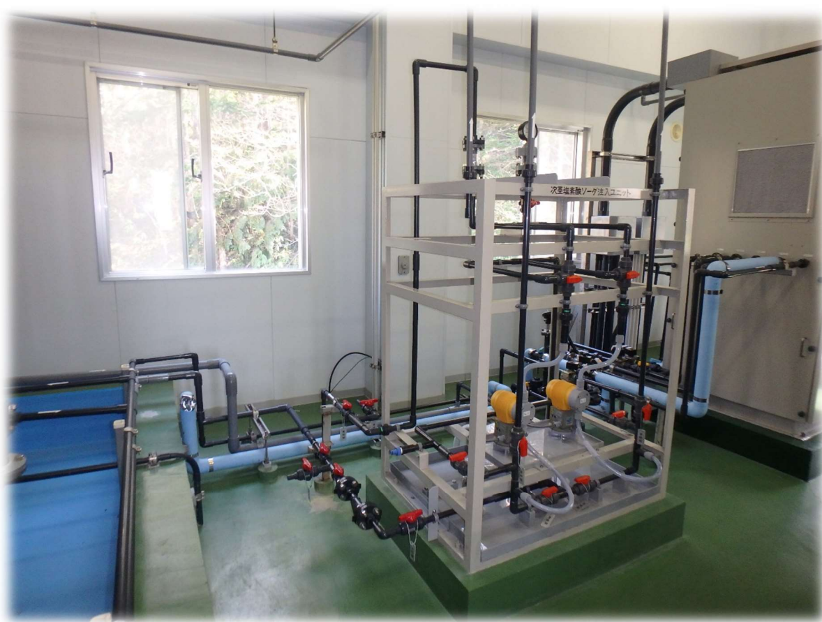
塩素注入設備 (高砂浄水場)
