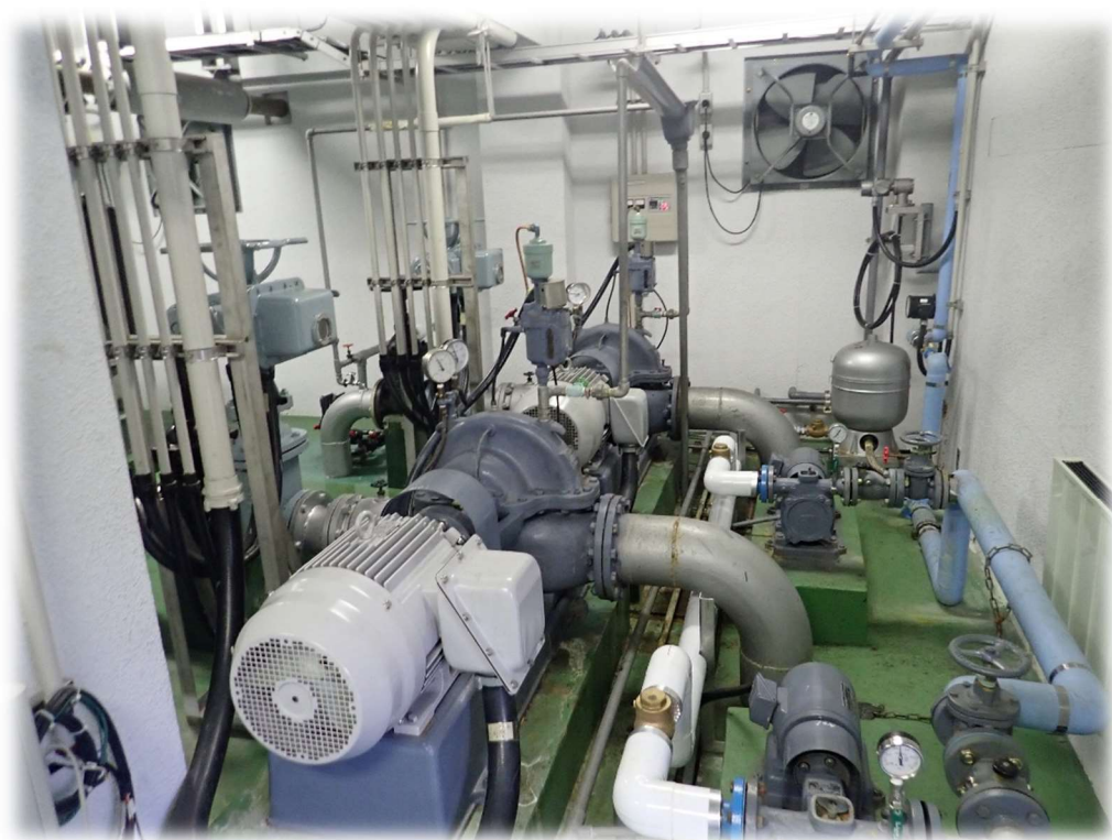
高砂浄水場(送水ポンプ)
