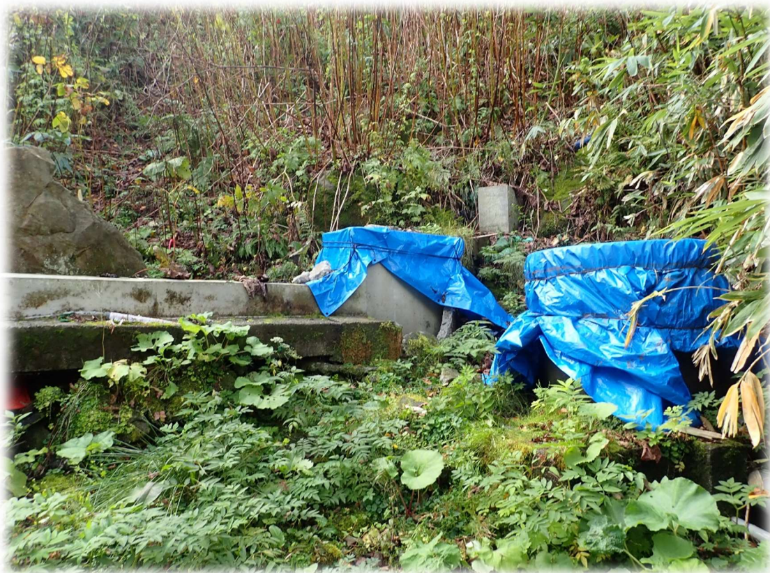
冷水川取水井
