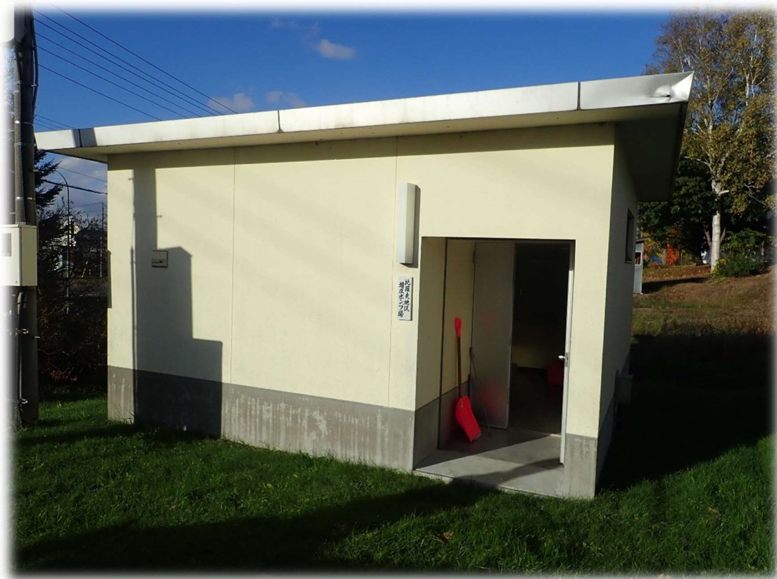
比羅夫増圧ポンプ場
