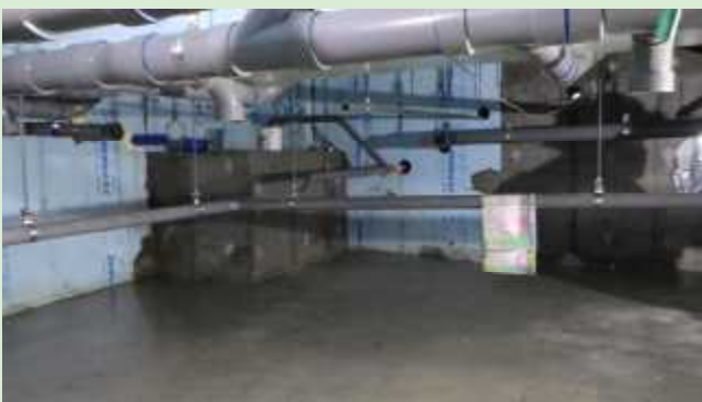
地下ピット配管の様子
