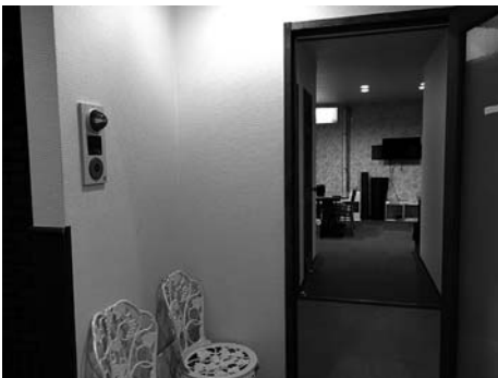
消防設備が設置されている簡易宿所
